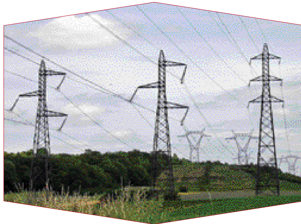
Les fils du réseau électrique de l'ONE ont tous un agrément et sont soumis à un contrôle régulier.
